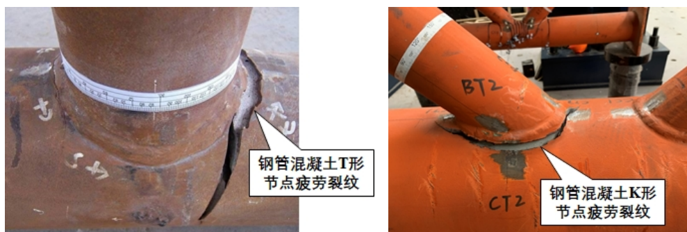
(a) 焊接节点疲劳裂纹
